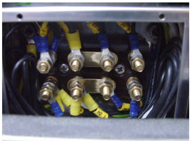
Fig. A.40: Generator power terminal box
